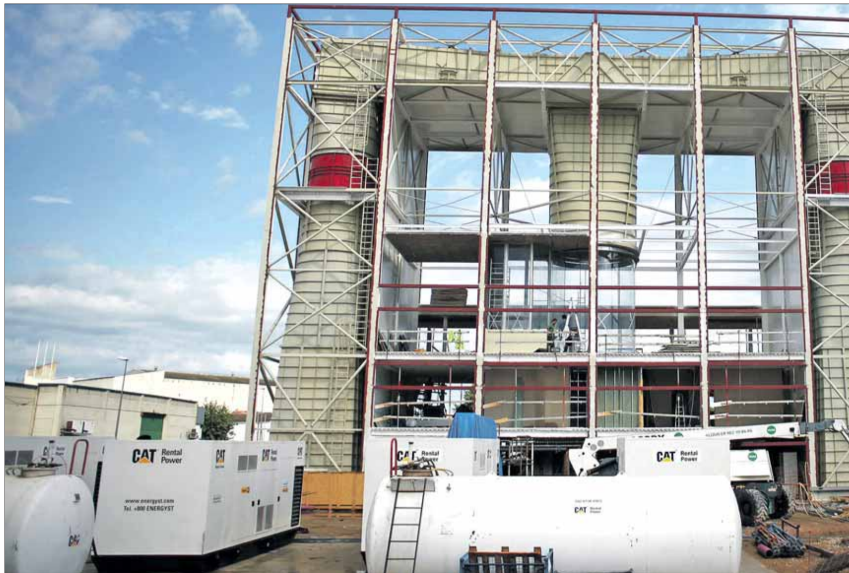
El túnel del vent d'Empuriabrava és una obra de gran envergadura i la seva construcció està enfilant aquests dies la recta final. MONTSENY EMPORDÀ SL
